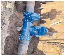
Conexión en Cártama.
